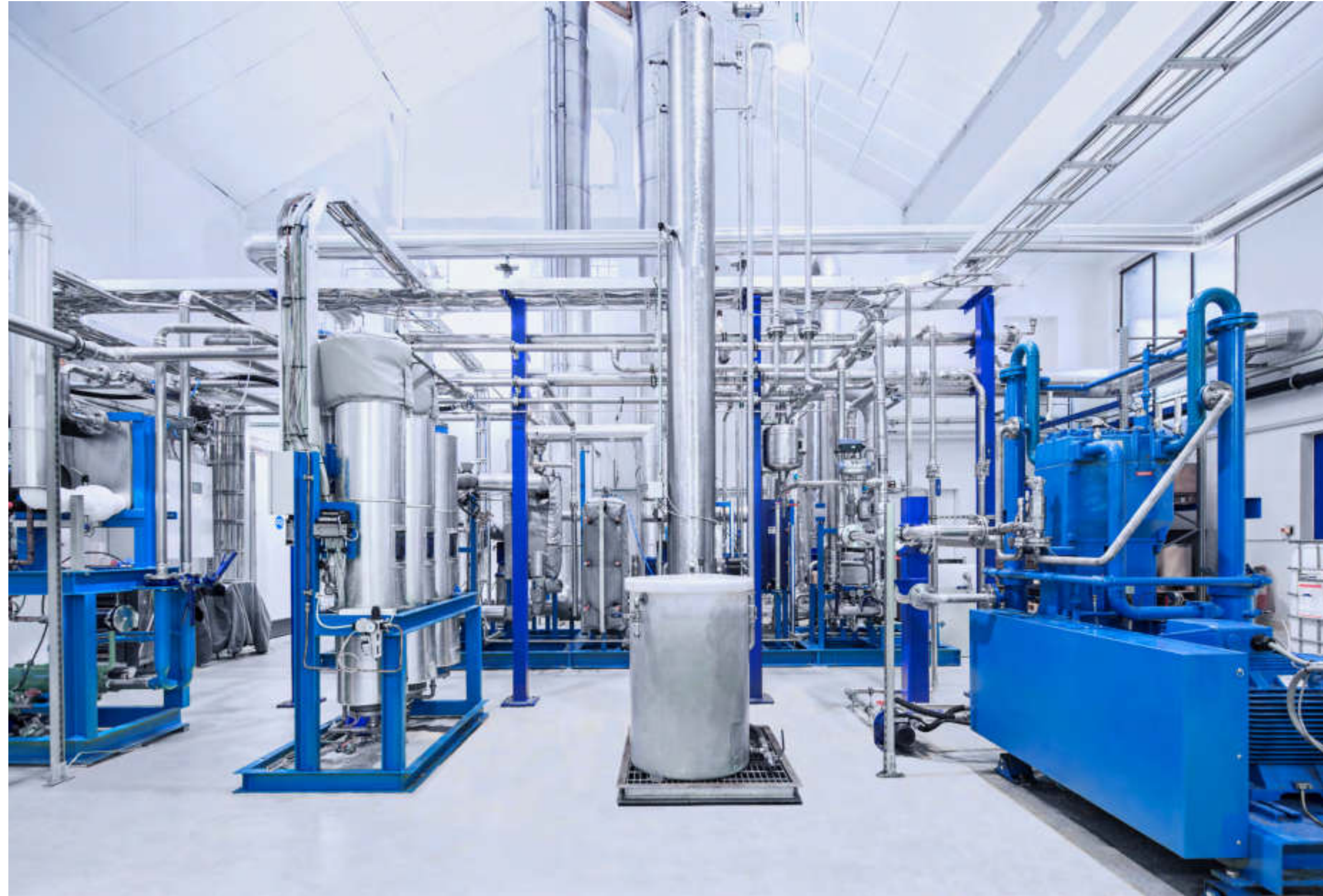
Beispielsfoto einer CO 2 -Rückgewinnungsanlage von Messer
